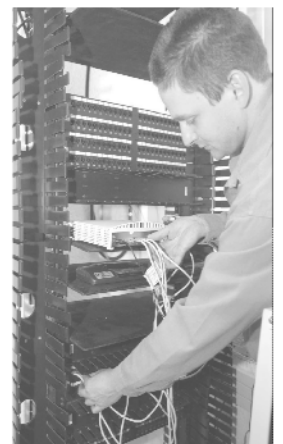
El punto de comunicación (RACK) entre los 40 distritos y el centro de cómputo del PREP
